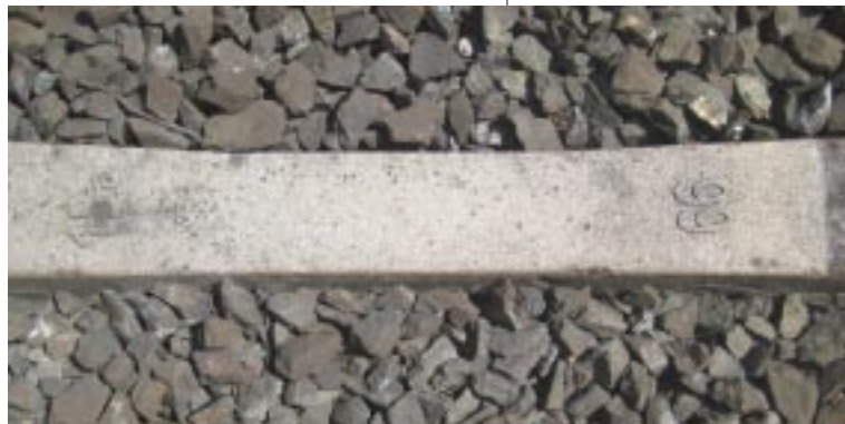
Bild 16: Besohlte Betonschwelle in einem Abschnitt mit geringer Schotterqualität
