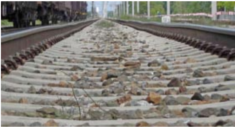
Bild 11: Mangelhafte Gleislage durch Setzungen im Untergrund
