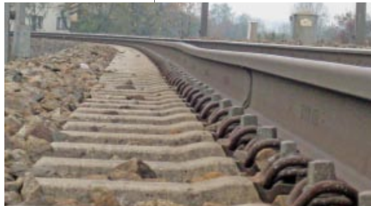
Bild 19: Setzungsunterschied am Übergang vom besohlenen auf unbesohlenen Abschnitt mit punktuellen Gleislagefehler
