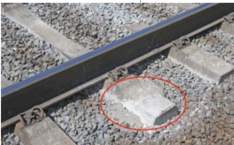
Bild 9: Gleis mit feinem Schotterabrieb am Schwellenende
