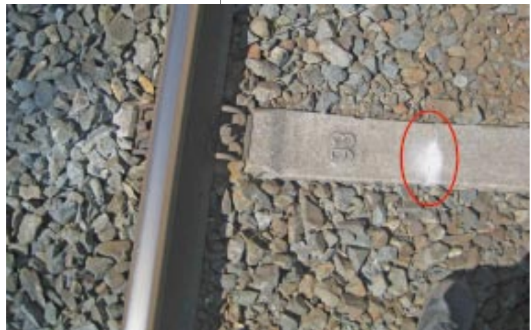
Bild 10: Schwelle mit Querriss infolge größerer Biegebeanspruchung
