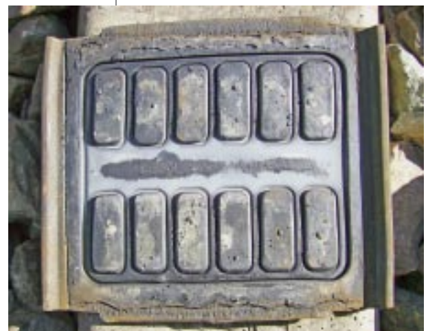
Bild 22: Fast verschleißfreie ausgebaute Zwischenlagen
